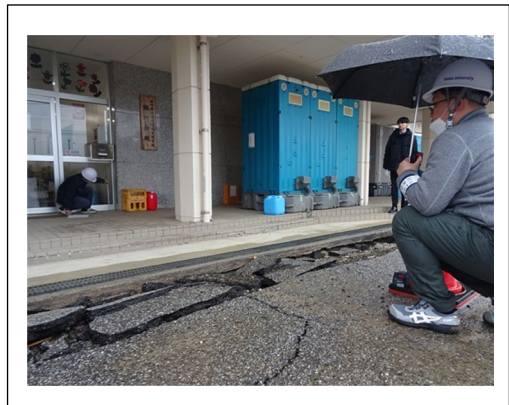
写真1 被災校舎の沈下を測る尹助教(右)
