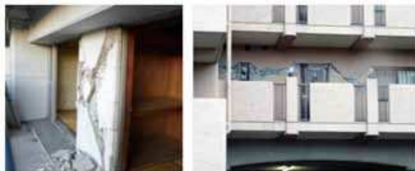
写真1 RC二次壁の地震被害例 (左：東日本大震災、右：熊本地震)
