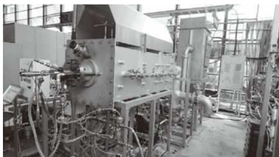
写真1 10kW級モデル工業炉の全景写真
