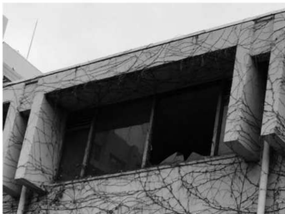
図3 大阪府北部地震による校舎の被害例
