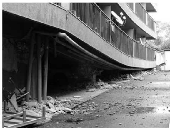
図2 熊本地震により層崩壊した建築例
