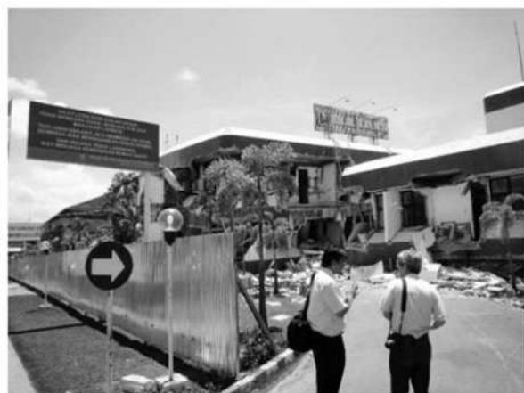
図4 スマトラ島沖地震により倒壊した建築例
