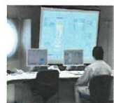
上下水道用 中央監視制御システム
