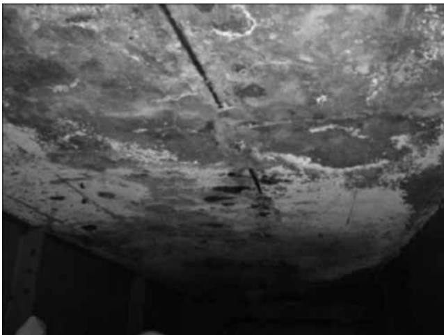
写真4 橋梁床版背面における鉄筋コンクリートの劣化状況
