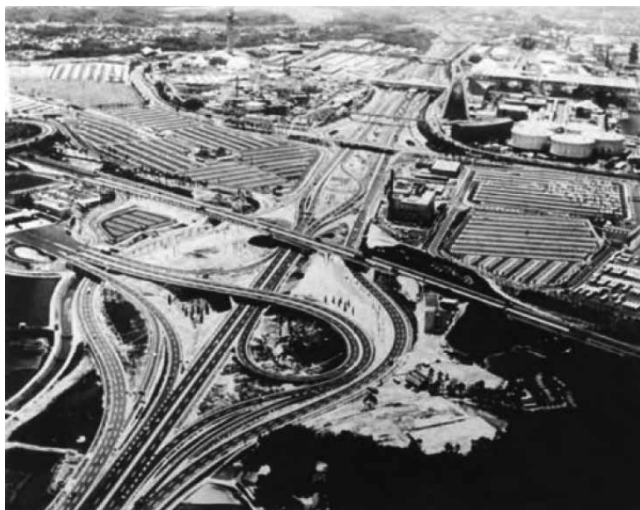
写真2 建設中の中国自動車道(吹田ジャンクション付近: 写真の奥右方に日本万国博覧会々場の日本館が見られる)
