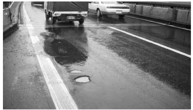
写真5 ポットホールの出現箇所（橋梁上）
